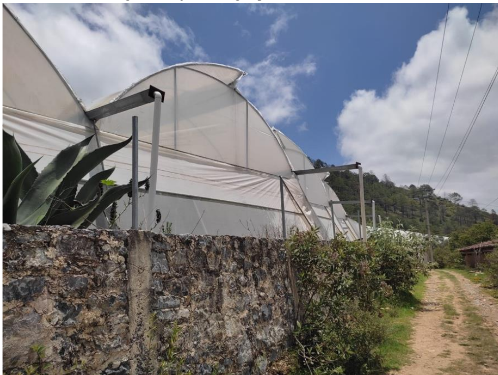
Figura 8. Bajadas de agua pluvial en el invernadero
