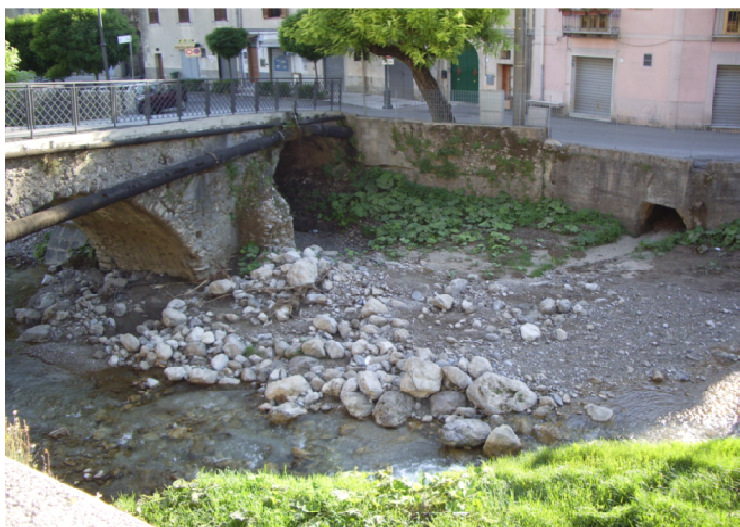
Fig. 6 - Il ponte situato al centro di Prepezzano di Giffoni Sei Casali, con il detrito depositato dalla colata del 30 luglio 2010 sul fondo alveo. Si nota la vicinanza delle abitazioni alle sponde del torrente.
