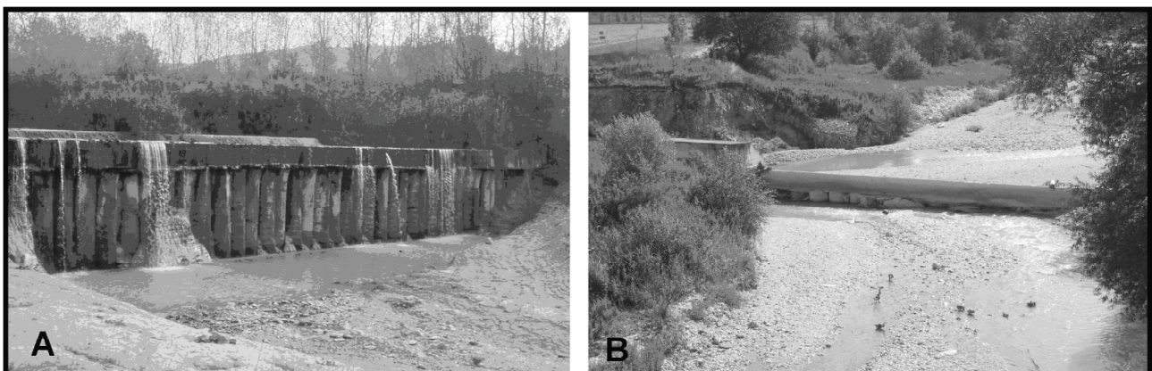
Fig. 3 - Evidenti fenomeni di scalzamento al piede: A) briglia nel fiume Tenna; B) traversa nel fiume Chienti.
