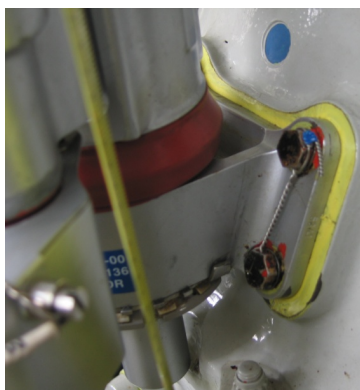
Figura 4: Attacco integro in condizioni di servizio. Figure 4: Intact attachment in exercise condition.
