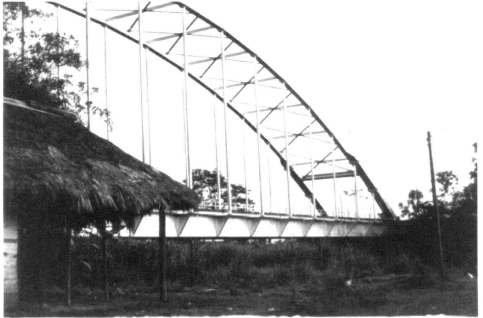
Figura 5. Puente del Opón. Refuerzo en el arco (obsérvese el tramo inicial y compárese con la figura 1).
