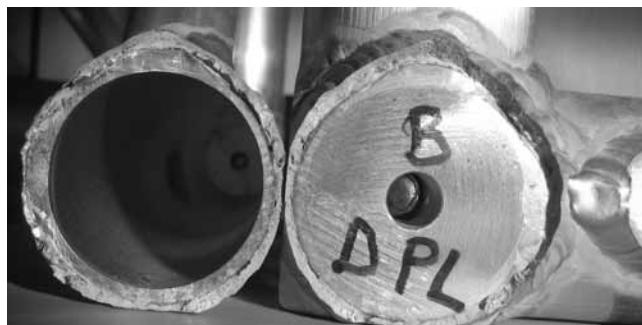
Rys. 6. Pęknięta spoina łącznika B (węzeł dolny przedni, lewa strona)
