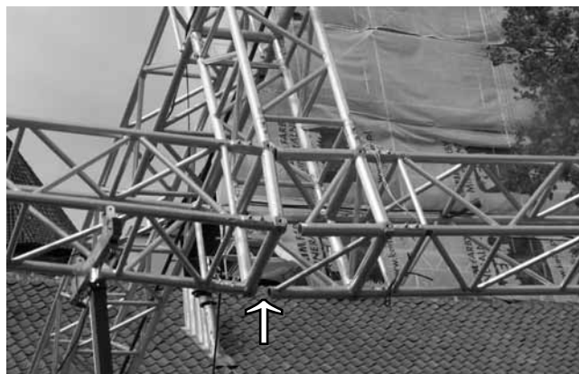
Rys. 2. Uszkodzony łącznik dźwigara tylnego Fig. 2. Damage roof back beam connector
