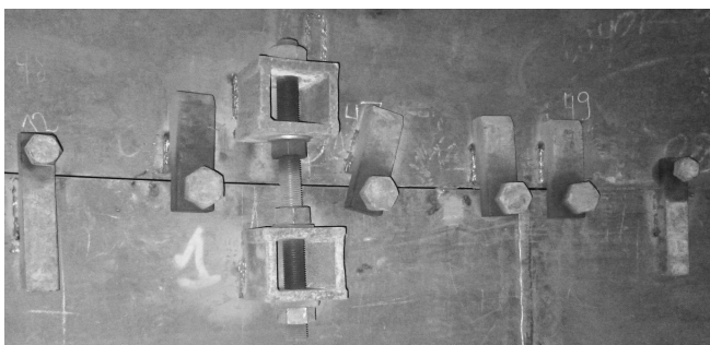
Rys. 4. Przygotowanie elementów do spawania Fig. 4. Preparation of the component to be welded
