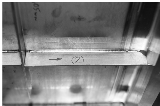
Rys. 14. Przykładowe braki ciągłości spoin w złączach usztywnień poprzecznych z blachą panelu spawanych laserem w miejscu występowania spoin panelu kadłuba nośnego Fig. 14. Exemplary lack of weld continuity in the laser welded joints of the transverse stiffening ribs with the casing panel in the area of the structural welds of the casing panel
